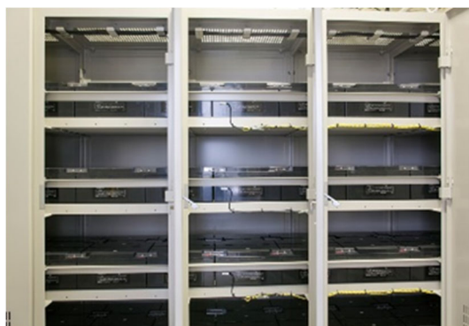
設置している鉛蓄電池
