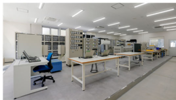
シミュレータ室
