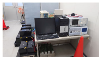
蓄電池再生試験
