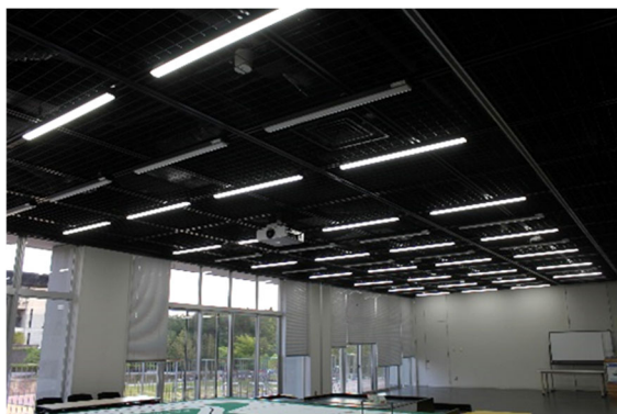
2 号館 1 階に導入した直流 LED 照明
