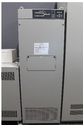
グリッド管理装置(20kVA)
