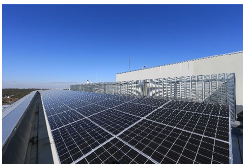
屋上の太陽光パネル
