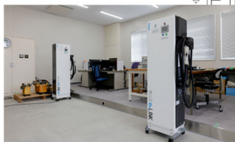
直流給配電・EV給電実験室
