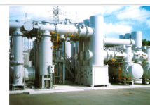
図1 電力機器（550kV GIS）※
