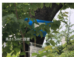
写真6 温湿度センサー設置状況
