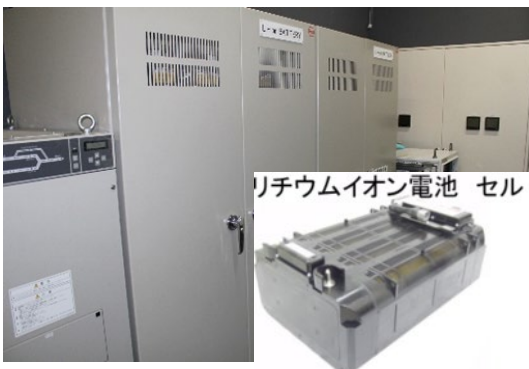
リチウムイオン電池装置
