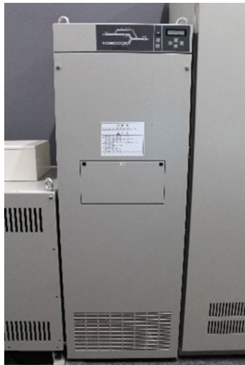
グリッド管理装置(20kVA)
