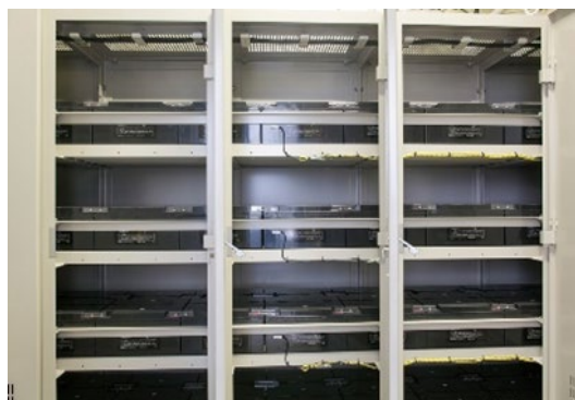
設置している鉛蓄電池
