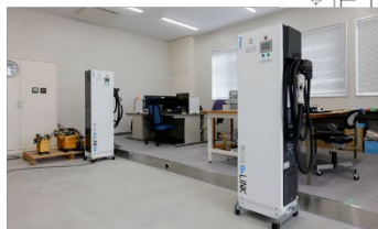
直流給配電・EV給電実験室
