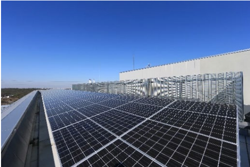
屋上の太陽光パネル
