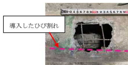
写真4 ヒューム管の内部鉄筋の腐食状況（図7の□部分）
