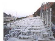
ガス絶縁開閉装置(GIS)
