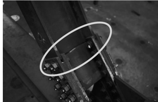
(d) ブレース材(D)の破断
