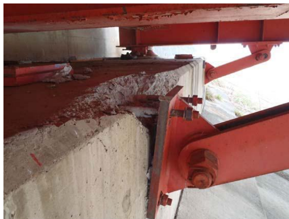
写真-1 落橋防止装置据え付け部の損傷事例
