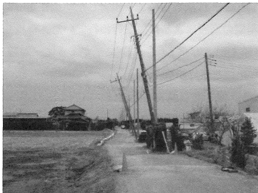
写真7 稲田を通る47道路脇電柱の傾斜
