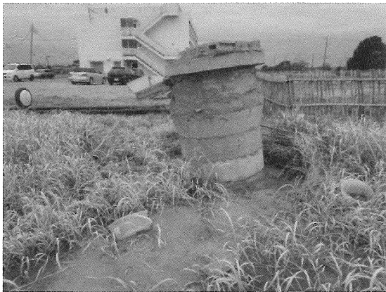
写真1 マンホール浮き上がり
