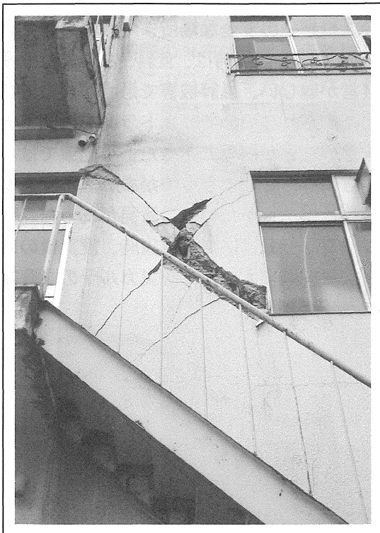
写真 15 RC3 階建て 2 階耐震壁の破壊 (小千谷総合病院検査棟)
