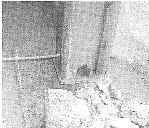
写真8 写真7建物の柱脚の破壊
