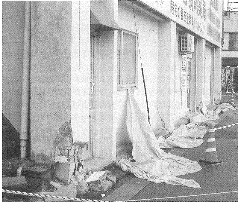
写真 14 RC3 階建て 1 階柱の破壊 (小千谷市)
