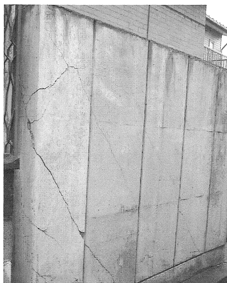
写真 13 写真 12 建物の 1 階外壁の 亀裂
