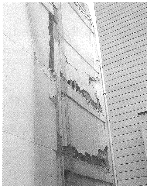
写真 11 RC 造 3 階建て外壁の破壊 (十日町市)
