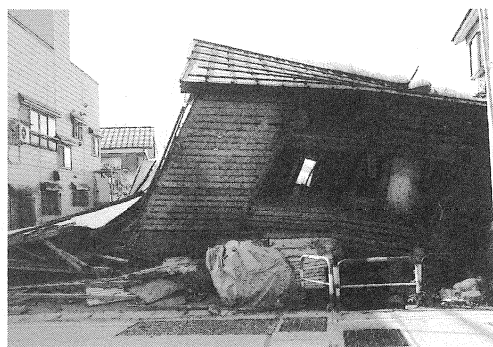
写真3 木造2階建て1階倒壊（川口町）
