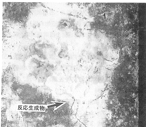
写真3 貯蔵370日における 人工海水浸漬供試体の劣化状況
