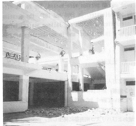
写真2 玄関棟屋根の崩落
