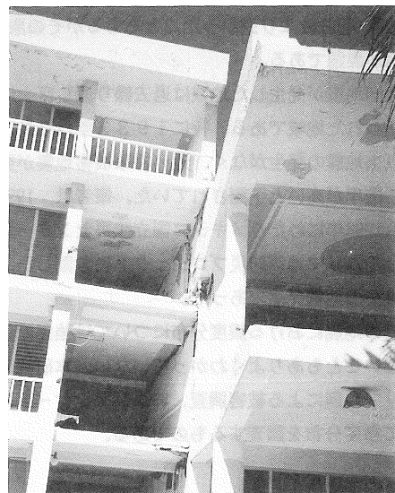
写真3 客室同志の衝突による被害
