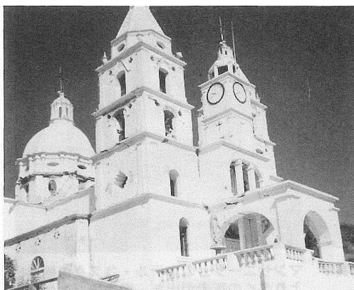
写真5 シアウルトラン教会ドームの亀裂
